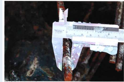
Bild 7: Feststellen des Bewehrungsdurchmessers mit der Schieblehre. An der Bruchstelle sind Korrosionsspuren erkennbar.
