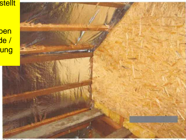
Bild 13: Dachgeschoss; hier trifft eine Rauntrennwand auf den Drenpel. Eine statisch wirksame Verbindung ist nicht erkennbar.
