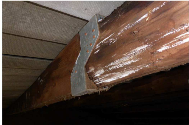
Pfette mit Schimmelpilzbefall
